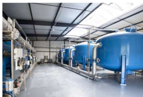
Nouvelle usine de potabilisation Orléans-La Source inaugurée en 2017 Source : Orléans Métropole
